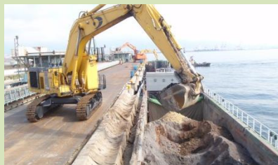
土砂落下防止シートにより陸揚げ時の廃棄物の海中への落下を防止
